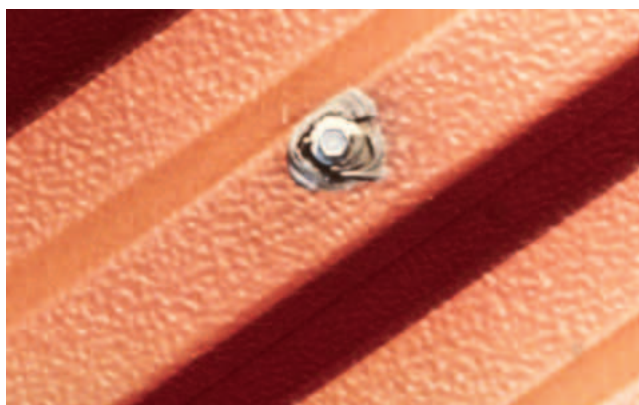
Uszkodzony wkręt na pokryciu dachowym.
